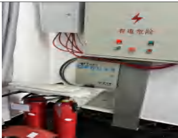
图 24 配电室配电箱下方绝缘胶垫，电工安全工具、灭火器
