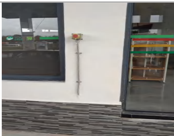
图 22 站房两侧靠近加油区两侧急停开关 2
