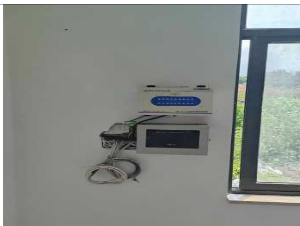
图 24 液位仪、测漏仪
