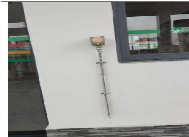
图 23 站房两侧靠近加油区两侧急停开关 2
