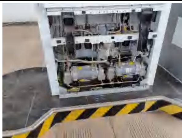
图 8 汽油加油机油气回收泵
